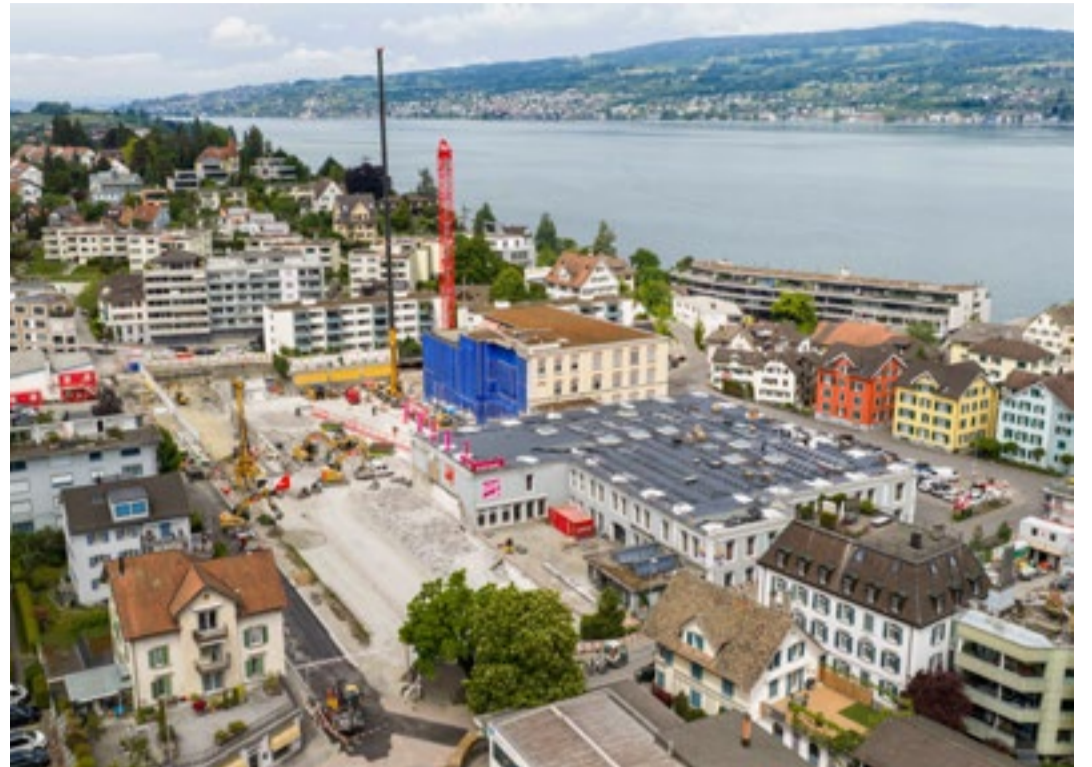
Während die Baugrube tiefer wird, werden auf dem Dach des Einkaufszentrums Solarpaneele installiert.
